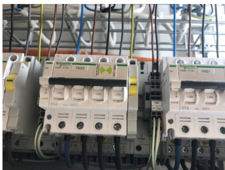
Marquage sur le disjoncteur
