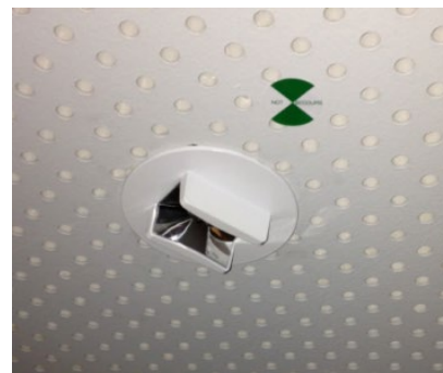
Marquage de l'éclairage
